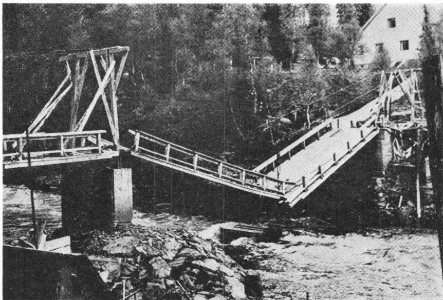
Fig. 9. Broen over Røyrvikelven ødelagt av vårflommen 1954.
